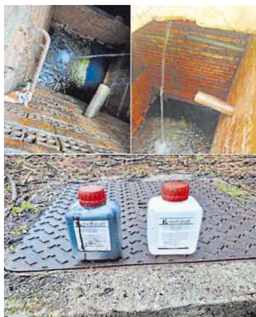
Lugar donde se detectó la conexión ilegal. | FdV
